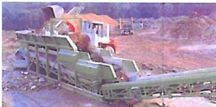
Planta de limpieza y clasificación RCD's
